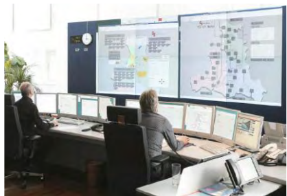
Steuerung MV-Netz über Leitstelle mit Spectrum Power
