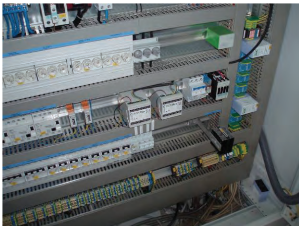
Abbildung 63: Eingebaute IRON-Box-Prototypen im laufenden Betrieb
