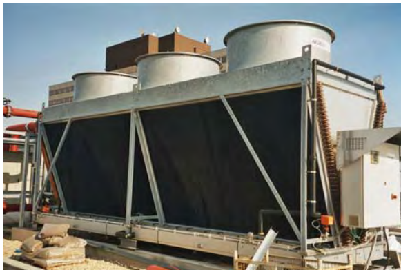
Abbildung 5: Fernkältezentrale TownTown: Hybridrückkühler
