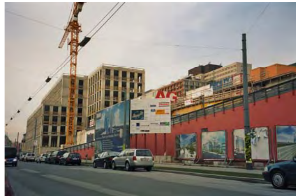
Abbildung 2: Bürogebäude TownTown mit Fernkältezentrale im Keller (CB05)
