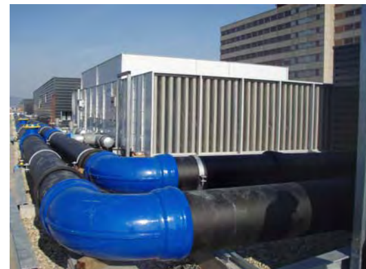
Abbildung 6: Fernkältezentrale TownTown: Offener Rückkühler
